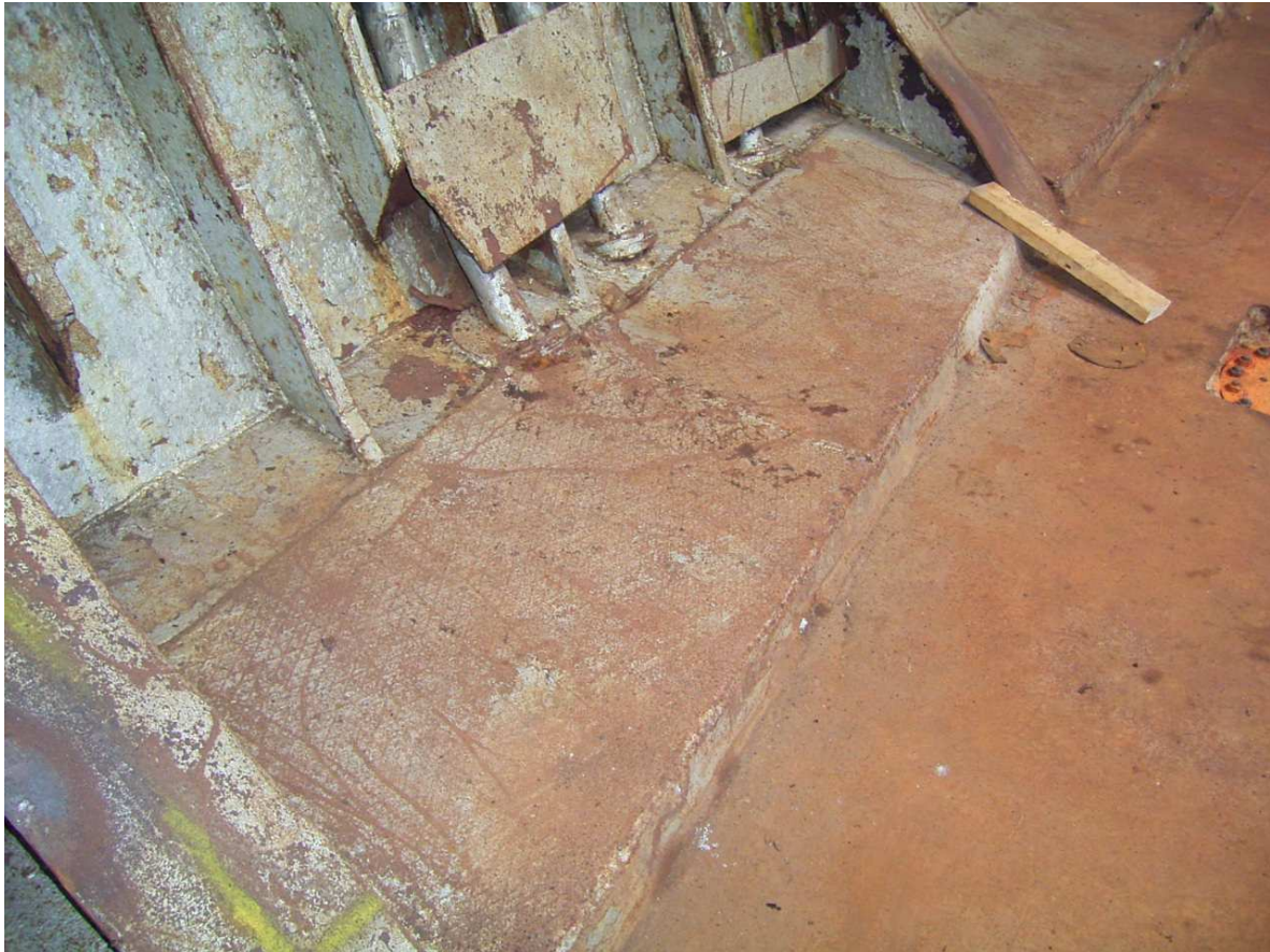
Die verschweißte Stahlabdeckung der Laderaumbilge in Luke 2
