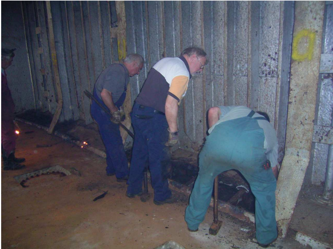
Wenn die Stahlplatten abgebrannt sind, muss die Holzwegerung entfernt werden. Mit vereinten Kräften wird diese Arbeit erledigt
